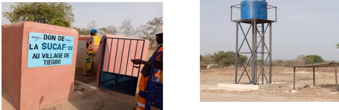
Figure N°2 : pompe hydraulique et retenue d'eau de Tiégbo
