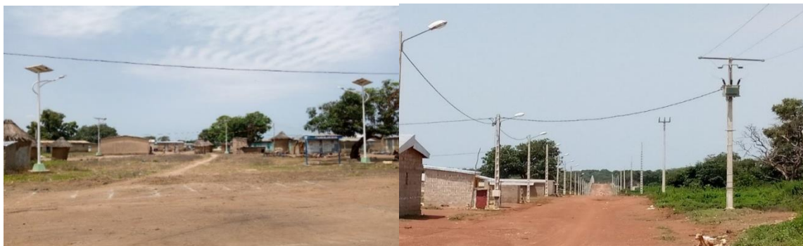
Figure N°3 : panneaux solaires, électrification et reprofilage de voies de Pangalakaha
