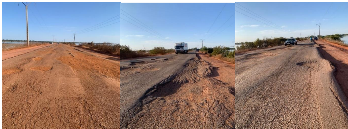
Figure 3 : État désastreux de la route nationale 5 axe Diouloulou-Bignona.
